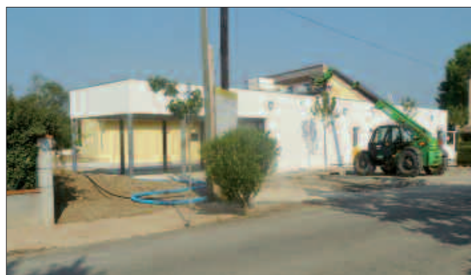
Crèche : peinture, aménagement des sanitaires, sols et faïences ainsi que la pose de la toiture végétale
